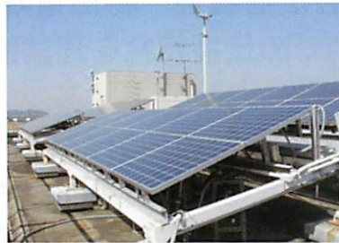
太陽光発電システム
